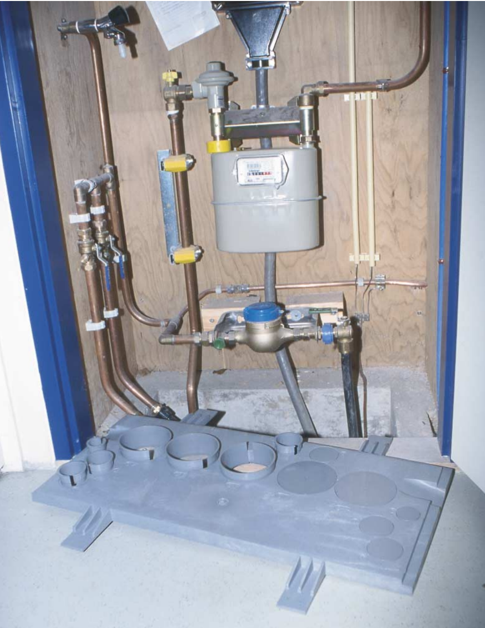
De meterkastvloerplaat heeft gezorgd voor uniformering in de aankomstkant van de meterkast.
